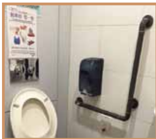
固定浴室扶手 Fixed handrail
